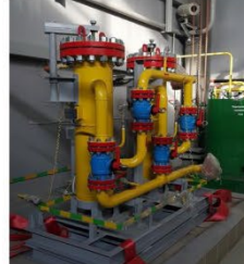
Блок фильтров топливного газа Ставропольское УПХГ КС "Рождественская" ООО «Газпром трансгаз Ставрополь»
