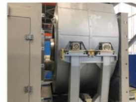
КМЧ ГТУ АЛ-31СТ (Газоотвод, трансмиссия и т.д.) ГТН-16Р ГП-1 "Бованенковского НГКМ" ООО «Газпром добыча Надым»
