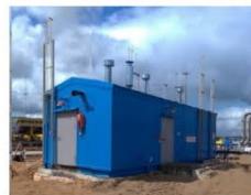
Системы обеспечения ГПА-16У КС "Новоприводинская" КС "Новоюбилейная" КС "Сосногорская" КС "Новоурдомская" КС "Новосидорская" КС "Новомикуньская" ООО «Газпром трансгаз Ухта»
