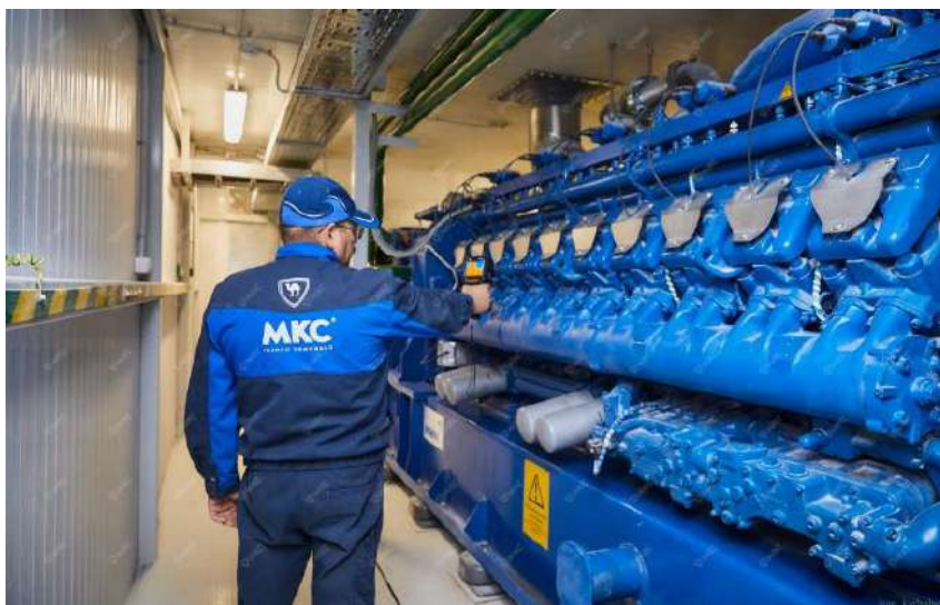
Рис. 1. Газопоршневая установка (ГПУ)
