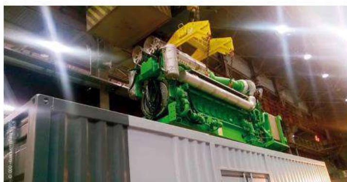
Рис. 2. Газовая теплоэлектростанция ООО «ПитерЭнергоМаш»
