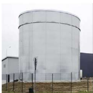
Резервуар для чистой питьевой воды объемом 1085 м 3 . Липецкая область, Грязинский район [8]
